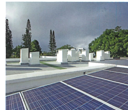
L'installation de capteurs photovoltaïques en toiture est dédiée à la recharge des vélos électriques.
